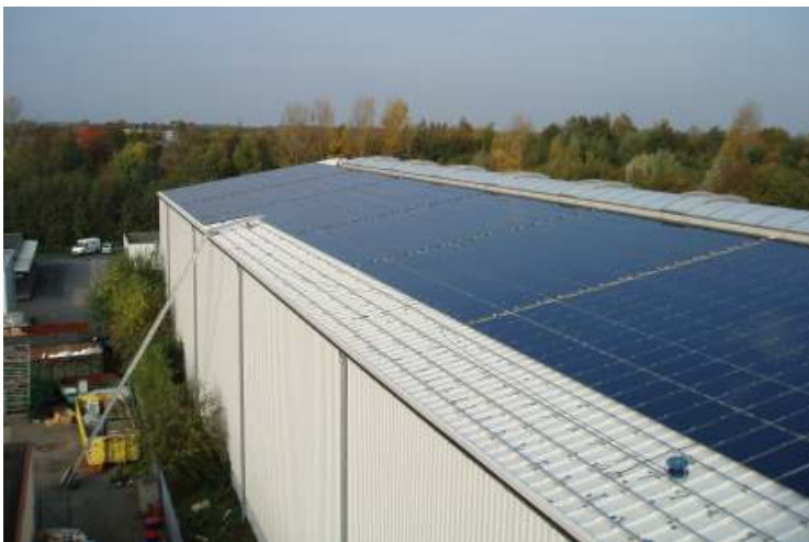
80 kWp Anlage auf Industriehalle
