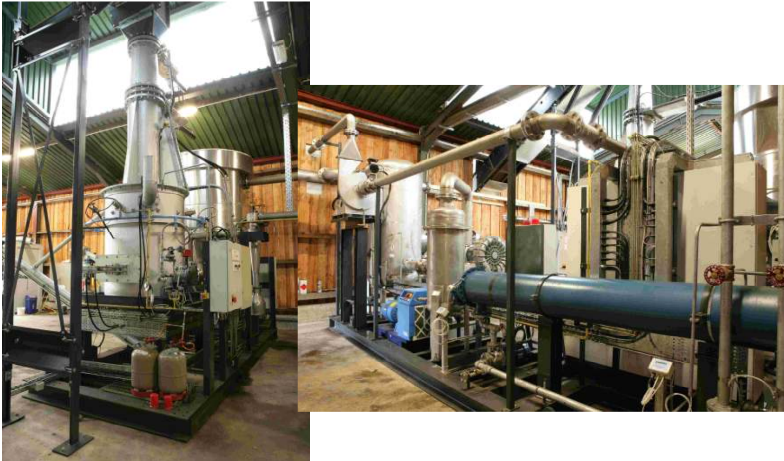
Frischholz-Vergasertechnologie mit Kraft-Wärme-Kopplung
