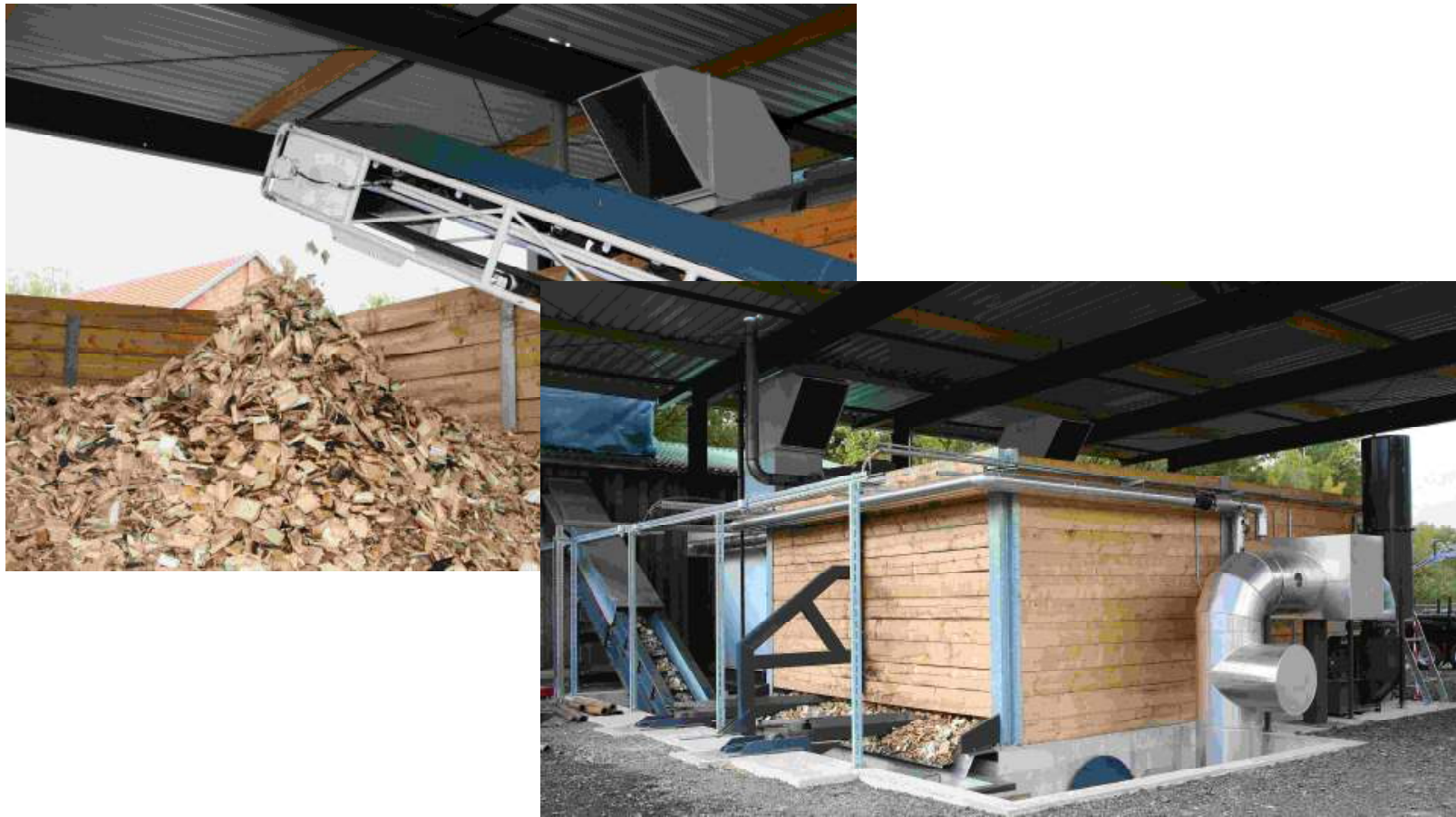
Frischholz-Vergasertechnologie mit Kraft-Wärme-Kopplung
