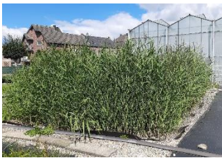
Abb. 36: Pflanzenkläranlage Versuchszentrum Gartenbau in Straelen
